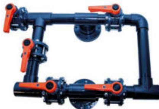
Batería de 5 válvulas con bridas
