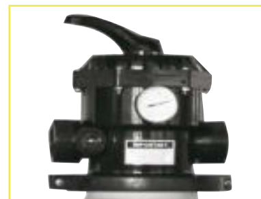
Válvulas y manómetro
